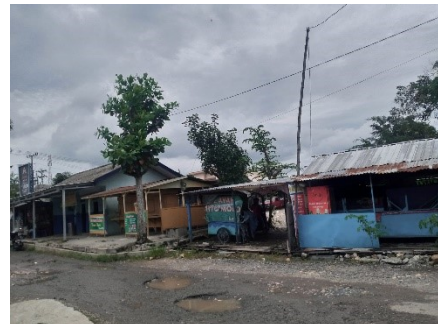
Gambar 6. Kondisi jalan masuk terminal (Sumber: Dokumentasi Pribadi, 2021)
