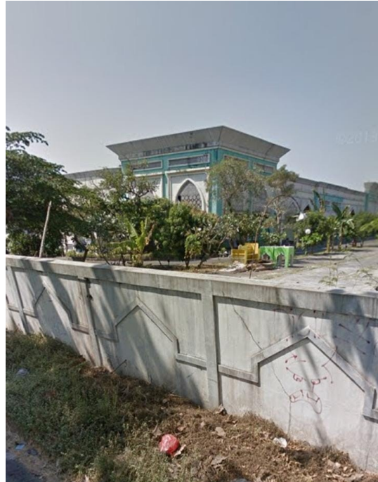
Gambar 13 Kondisi Fasad belakang Goro Assalam
