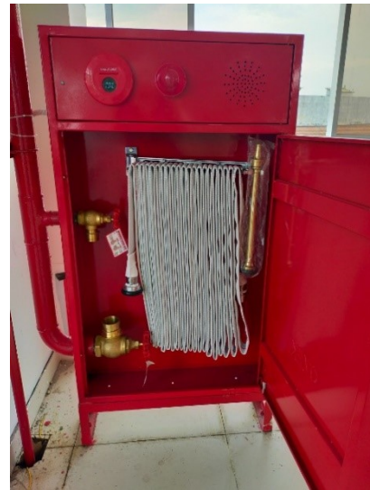
Gambar 7. Hydrant Box (Sumber: Dokumentasi Pribadi 2021)
