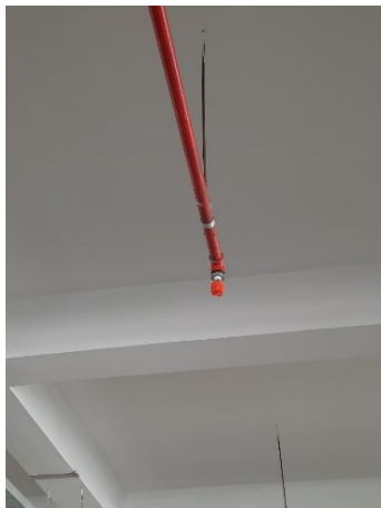
Gambar 5. Sprinkler Yang Terpasang (Sumber: Dokumentasi Pribadi 2021)
