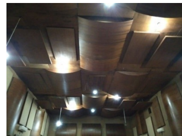
Gambar 9. ceiling Panel Akustik Ruang Studio Lokananta. [Pribadi,2021]
