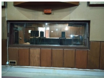
Gambar 11. Kaca Pembatas Control Room. (Sumber: Pribadi, 2021)
