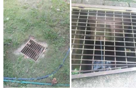
Gambar 8 & 9 Lubang Air Hujan
