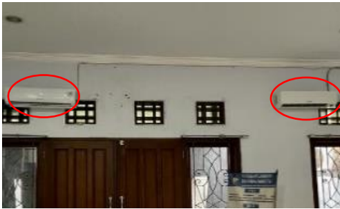
Gambar 3. AC sebagai sumber bukaan pada bangunan (Sumber: Dokumentasi Peneliti, 2022)
