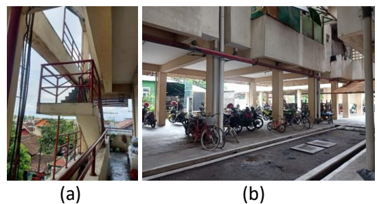
Gambar 14. (a) Tangga darurat (b) Sprinkel (Sumber: Dokumentasi pribadi, 2022)
