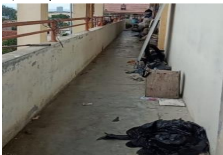
Gambar 12. Koridor yang bau kotoran hewan (Sumber: Dokumentasi pribadi, 2022)
