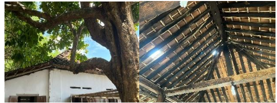
Gambar 8. Kondisi atap bangunan rumah Bunker Laweyan Solo (Sumber: Dokumen Penulis, 2022)
