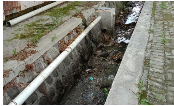
Gambar 14. Selokan berbau tidak sedap (Sumber: Dokumentasi Penulis,2022 )
