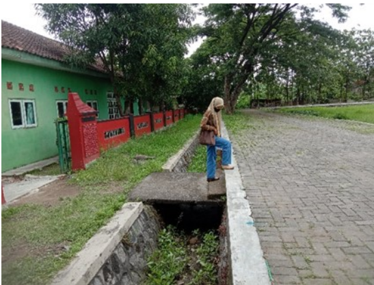
Gambar 13. Elevasi anak tangga yang tidak sesuai (Sumber: Dokumentasi Penulis, 2022)
