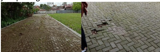
Gambar 12. Kondisi paving block pada lapangan (Sumber: Dokumentasi Penulis, 2022)
