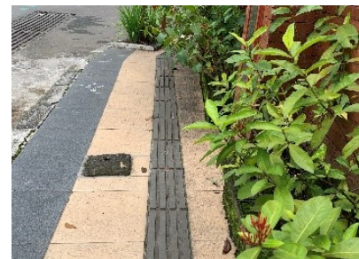
Gambar 11. Vegetasi yang menghalangi jalan (sumber: Dokumentasi penulis, 2022)
