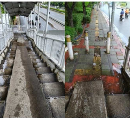
Gambar 8. Genangan Air JPO di Jl. Gatot Subroto (sumber: Dokumentasi Penulis, 2022)
