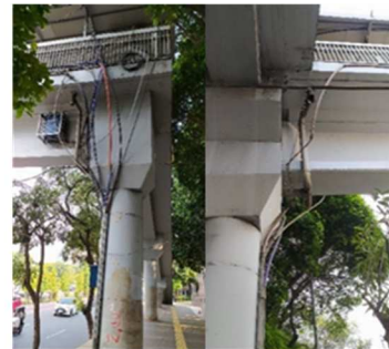
Gambar 12. Sistem kelistrikan dan pipa (sumber: Dokumentasi Penulis, 2022)
