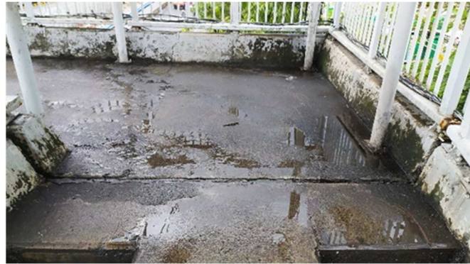
Gambar 7. Genangan Air JPO di Jl. Gatot Subroto (sumber: Dokumentasi Penulis, 2022)
