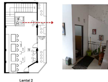
Gambar 16. Kondisi toilet (sumber: Dokumentasi Penulis, 2022)
