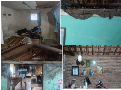
Gambar 6. Kondisi Dinding pada Beberapa Sampel (Sumber: Dokumen Peneliti, 2021)
