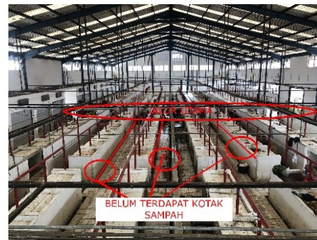
Gambar 6. Kondisi Ruang Pasar Rakyat Lebong (Sumber: Dokumentasi Pribadi 2021)
