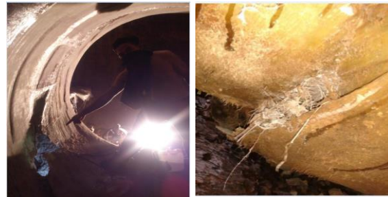
Gambar 2. CWP yang retak
