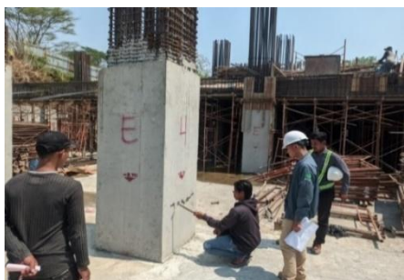
Gambar 2. Pengecekan dan pengukuran diameter titik keropos (sumber: Dokumentasi)
