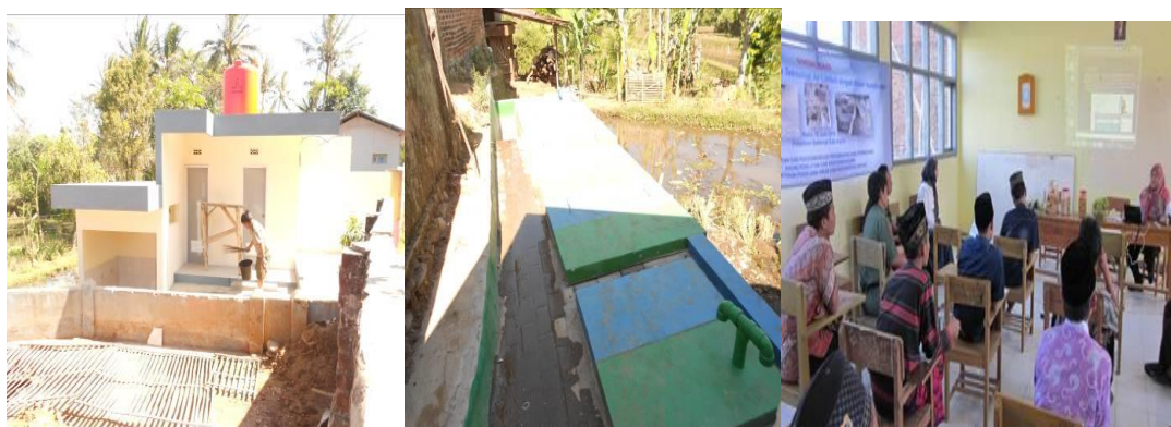
Gambar 2. Bangunan MCK ,pengolahan IPAL vermibiofilter & Sosialisasi kepada Masyarakat Pondok Pesantren Sukaraja, Desa Jatisari, Kec Karangpawitan Kab.Garut
