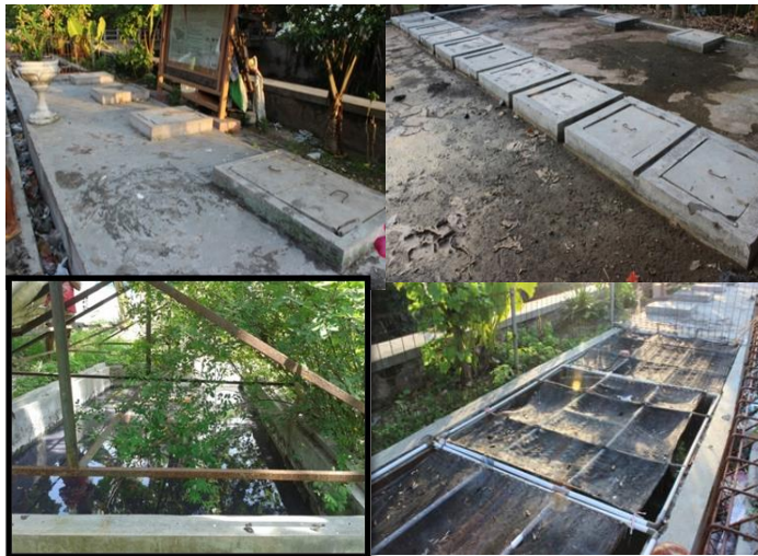
Gambar 5. Kondisi IPAL Komunal Pada Saat Masih Beroperasi.
