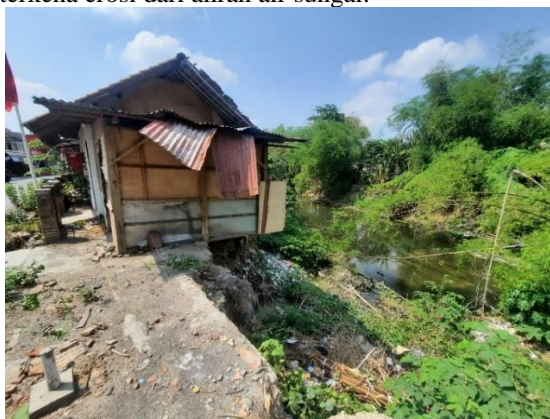
Gambar 2 Kondisi Bangunan yang berada di pinggir sungai hulu belum bertanggul
