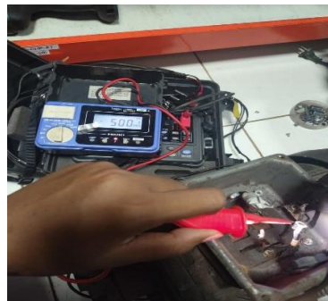
Gambar 3. Nilai Megger saat Pengukuran
