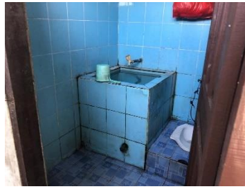
Gambar 1. Hasil Dokumentasi Keadaan Toilet di Pagi Hari
