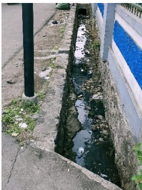
Gambar 7. Kondisi Selokan Terminal (Sumber: Dokumentasi Penulis, 2021)
