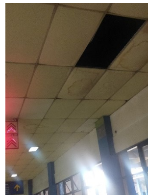
Gambar 4. Kondisi Plafond Terminal (Sumber: Dokumentasi Penulis, 2021)
