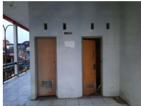
Gambar 2. Kondisi Toilet Pasar Ir. Soekarno
