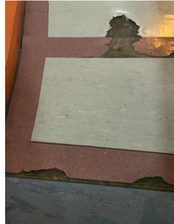
Gambar 14. Kerusakan pada Permukaan Ramp (sumber: Dokumen Penulis, 2023)
