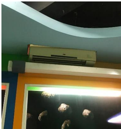
Gambar 12. Penghawaan Buatan yang Tidak Berfungsi
