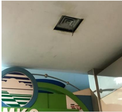
Gambar 11. Penghawaan Buatan yang Tidak Berfungsi
