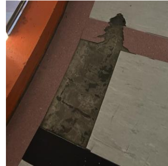
Gambar 13. Kerusakan pada Permukaan Ramp (sumber: Dokumen Penulis, 2023)
