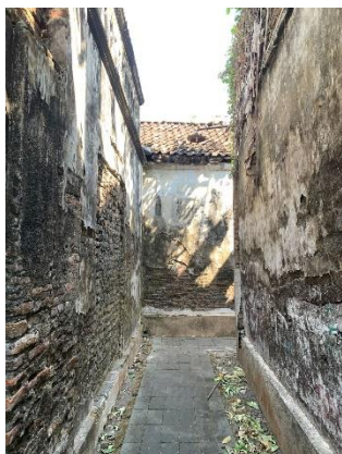
Gambar 3. Jalan yang diapit tembok tinggi (sumber : Dokumentasi Penulis, 2024)
