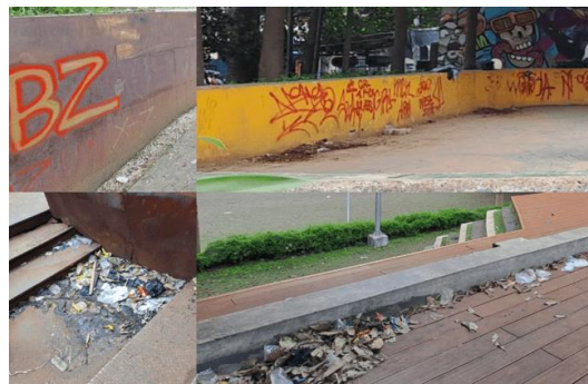
Gambar 15. Kerusakan, Sampah, dan Vandalisme (Sumber: Dokumentasi Penulis, 2024)
