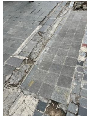
Gambar 7. Kerusakan pada pedestrian Braga (Sumber : Dokumentasi penulis, 2024)
