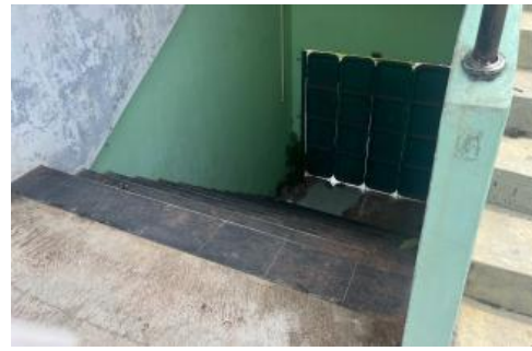
Gambar 17. Kondisi Tangga ke atas Tribun Timur (Sumber: Dokumen Penulis, 2024)
