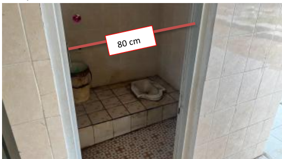
Gambar 22. Kondisi Toilet Stadion Trikoyo (Sumber: Dokumen penulis, 2024)
