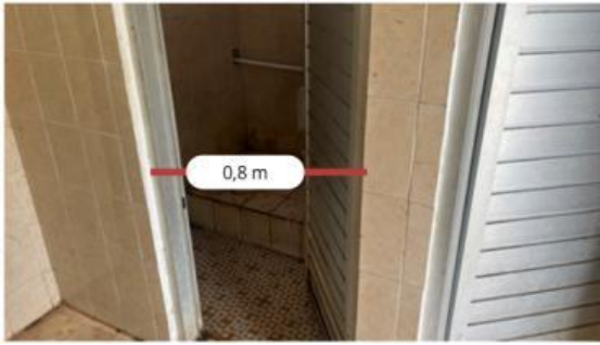
Gambar 25. Kondisi Toilet Stadion Trikoyo (Sumber: Dokumen penulis, 2024)
