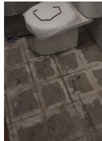
Gambar 25. Lantai Toilet (Sumber: Penulis, 2024)
