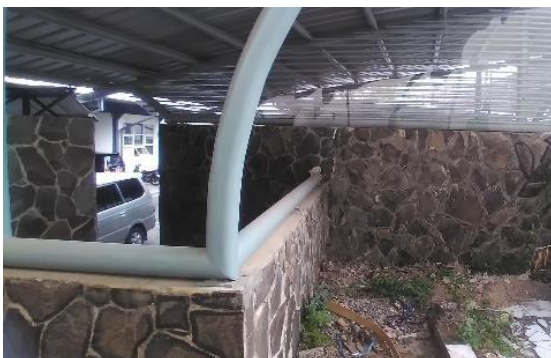
Gambar 7. Kondisi dinding ruang wudhu bagian atas (sumber: Dokumen Penulis, 2024)
