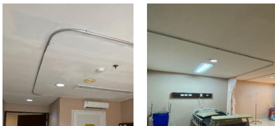
Gambar 6 (Kiri) Lampu pada Ruang Crystal 515; (Kanan) Lampu pada Ruang Crystal 527 (Sumber : Dokumen Penulis,2024)
