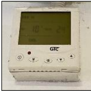
Gambar 19. Alat Thermostat Pada Ruang (sumber : Dokumentasi Penulis, 2024)
