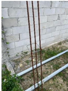
Gambar 1. Besi Tulangan Dengan Diameter Tidak Sesuai Standar (Sumber : Dokumen Penulis, 2025)
