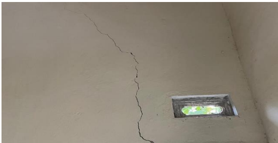
Gambar 6 : Foto Dinding Retak Rambut (Sumber : Dokumen Penulis, 2025)
