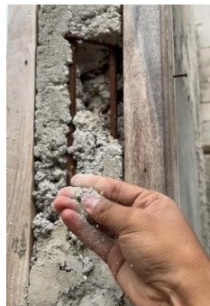
Gambar 2. Komposisi Campuran Beton Yang Tidak Sesuai (Sumber : Dokumen Penulis, 2025)
