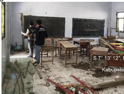
Gambar 5. Kondisi lantai sekolah retak SMP N 03 Kandangserang (sumber: Dokumen Penulis, 2025)
