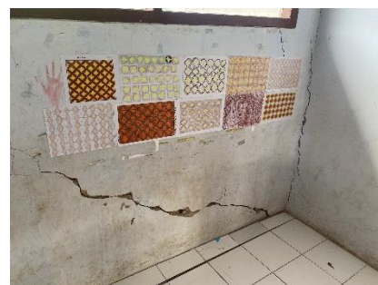
Gambar 4. Kondisi dinding retak rambut SD N 01 Sidomulyo (sumber: Dokumen Penulis,2025)
