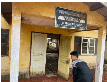
Gambar 3. Kondisi Kusen Pintu dan Kusen Jendela bangunan SD N 3 Mulyorejo (sumber: Dokumen Penulis,2025)
