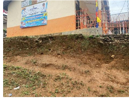
Gambar 6. Kondisi longsor di sekitar pondasi sekolah SD N 02 Winduaji (sumber: Dokumen Penulis, 2025)
