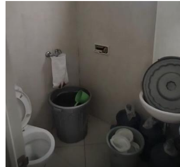
Gambar 9. Kondisi toilet eksisting (Sumber: Dokumen Penulis, 2025)
