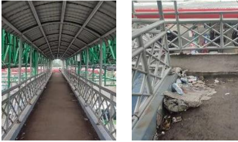
Gambar 4. Kondisi Lorong dan Kebersihan JPO Bundaran Alam Sutera (Sumber: Dokumentasi Penulis, 2025)
