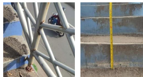
Gambar 2. Kondisi Pagar Pembatas dan Ketinggian Anak Tangga JPO Bundaran Alam Sutera
