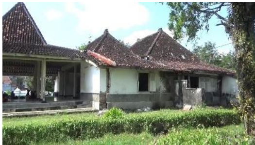
Gambar 5. Kondisi Bangunan Kepatihan Ngawi (Sumber: Google, diolah penulis, 2025)
