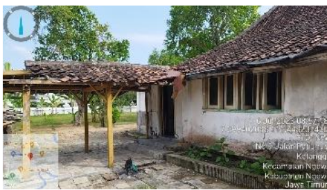
Gambar 12. Kondisi atap dan struktur kayu Bangunan Kepatihan Ngawi
