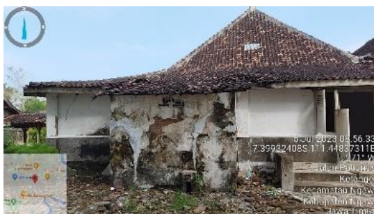
Gambar 9. Kondisi dinding bangunan yang mengalami retak (Sumber: Dokumentasi Penulis, 2025)
