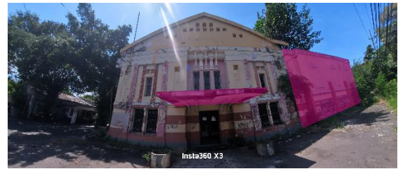
Gambar 8. Foto Menunjukkan Elemen Baru yang Merupakan Tambahan Bukan Elemen atau Struktur Asli
