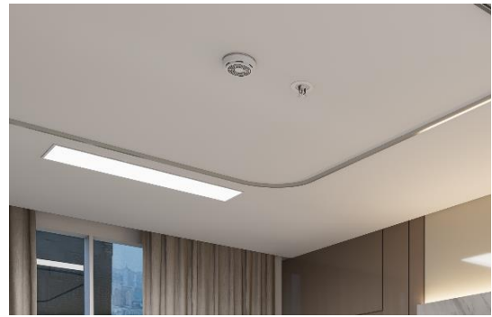
Gambar 12. Sprinkler dan Smoke Detector Ruang VIP&VVIP
