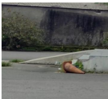
Gambar 2. Ramp yang Tidak Sesuai standar (Sumber : dokumen pribadi penulis, 2025)
