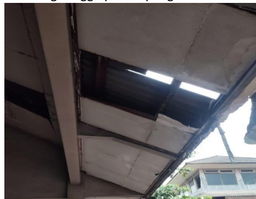
Gambar 9. Dokumentasi Plafon Runtuhi (Sumber dokumen pribadi penulis, 2025)
