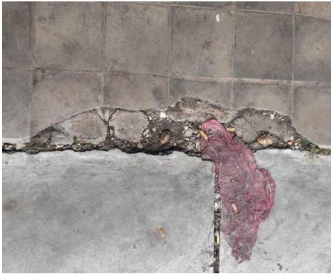
Gambar 10. Dokumentasi lantai rusak (Sumber dokumen pribadi penulis)
