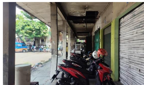
Gambar 3. Rusaknya Plafon Terminal Palur (Sumber : dokumen pribadi penulis, 2025)
