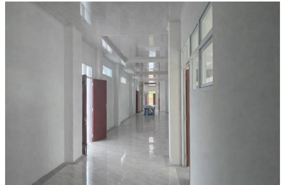
Gambar 2. Selasar bangunan tidak ada ventilasi silang (Sumber: Dokumentasi Penulis, 2025)
