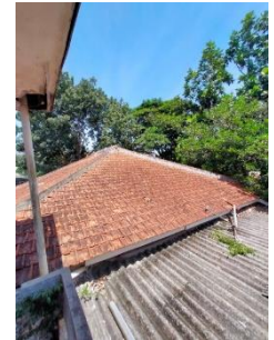
Gambar 8. Atap asbes (sumber:Dokumen Pribadi, 2025)
