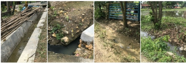
Gambar 9. Keadaan Selokan Drainase Kawasan (Sumber: Dokumen Pribadi)
