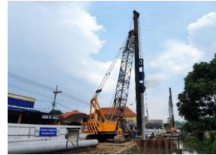
Gambar 2. Crane Preboring (Dokumentasi Pribadi, 2022)
