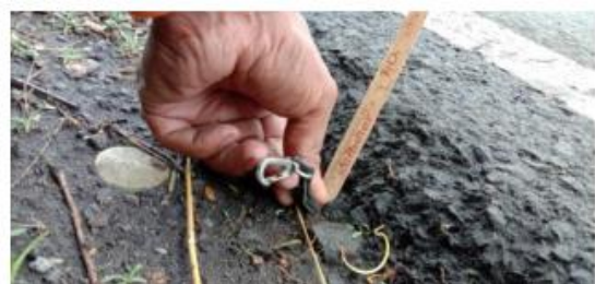
Gambar 8. Perbedaan ketinggian badan dan bahu jalan segmen 5
