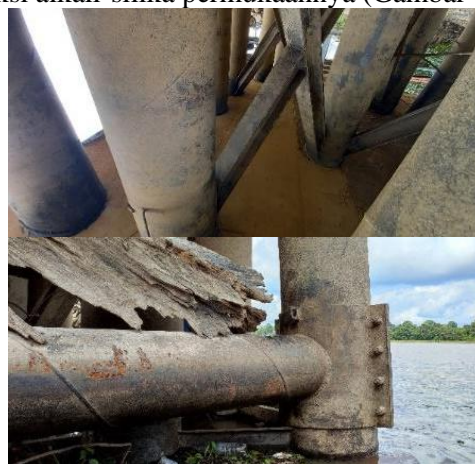
Gambar 9. Korosi pada permukaan struktur pondasi Jibcrane
