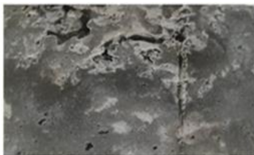
Gambar 3. Retakan beton setelah perendaman selama 7 hari. (Lirawati dkk., 2024)
