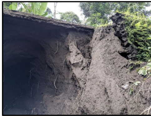
Gambar 3. Kondisi eksisting gorong-gorong dan talud longsor di ruas Jalan Logede-Ngemplak
