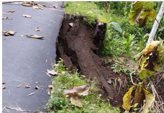
Gambar 1. Tampilan Existing Longsoran
